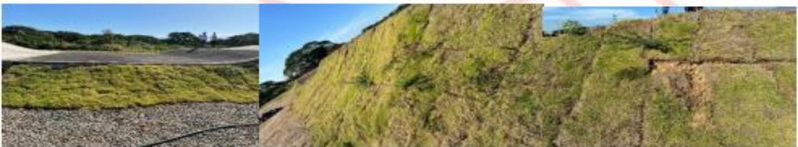
Erosión en los taludes de la pista
